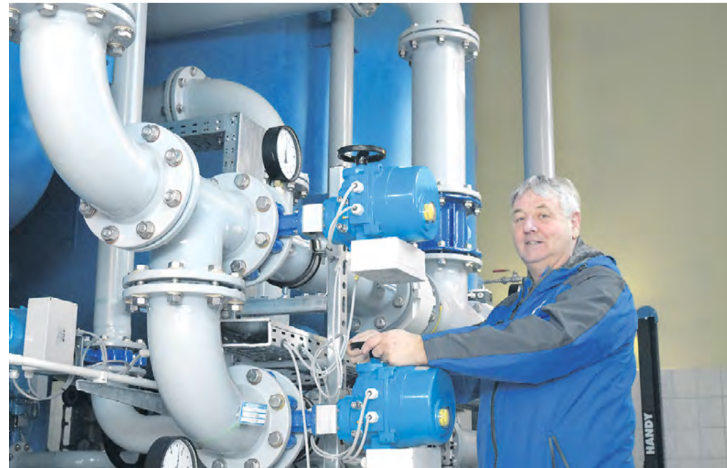
Sven Köhler kontrolliert regelmäßig die Filter der Wasserwerke.
