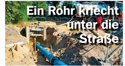
Die Trinkwasserleitung unter der Börnicker Chaussee wird im modernen Horizontalspülbohrverfahren verlegt. Statt die Straße tagelang zu sperren, den Verkehr umzuleiten und dann die Bitumentdecke aufzureißen, gräbt sich ein großer Bohrer durch die Erde und zieht das Rohr wie einen Faden hinter sich ein. „Das Verfahren ist zwar kostenintensiver, als die traditionelle Bauweise. Wir versuchen, die Bauarbeiten im WAV nicht nur so effizient wie möglich zu organisieren, sondern auch kundenfreundlich“, so Daniel Nicodem. Foto: WAV/Nicodem
